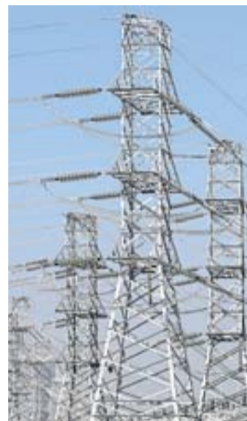
Torres de distribución eléctrica.
